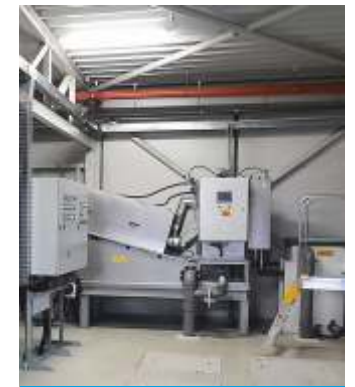
Strojní odvodnění kalu
