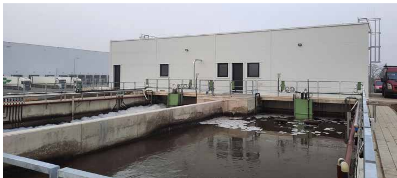
ČOV – 235 m 3 , CTP park Kozomín, ČR
